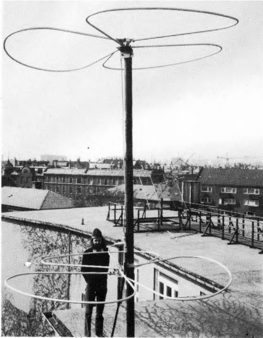
Dobbelt treklover monteret på Københavns Teknikums antenne-tag.
