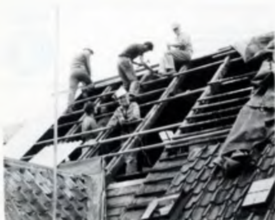
Tegltaget på OZ5EDR, Theklavej, udskiftes med eternitplader. I øverste række ses følgende hams: Med ryggen til, OZ1RS, Rønnow, med hammeren OZ5RT, Bent, og med P35 i hånden OZ6MK, Mogens. I forreste række OZ1CKG, Poul-Erik (med ryggen til) og OZ9SN, Svend.
