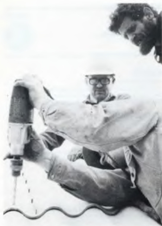
Der bores i eternitpladerne under tagudskiftningen på OZ5EDR, Theklavej. Liggende, med boremaskinen ses OZ6MK, Mogens. Bag ham OZ1RS, Rønnow, og i øverste højre hjørne OZ5RT, Bent.
